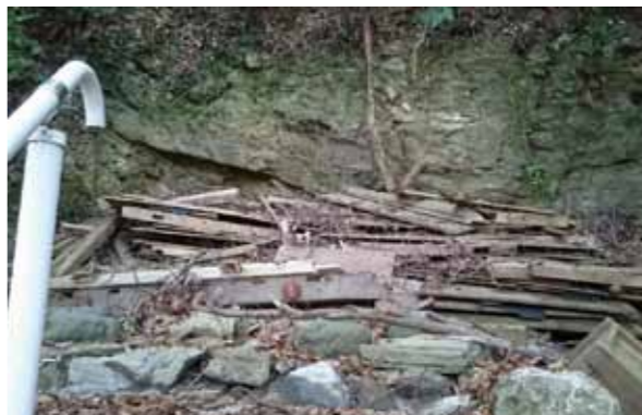
管理人不在のまま極限まで荒廃し、ついには木屑となってしまった神社(徳島県某所)。もとは格式の高い神社であったが、見る影もない。このような状態の神社が、全国レベルで見れば数え切れないほど存在する。
